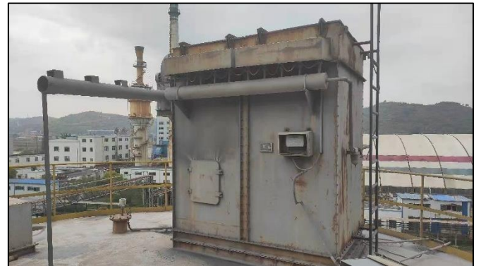
粉煤灰仓配套脉冲布袋除尘器
